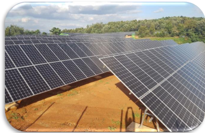
화성 주곡리 태양광 발전소 (1Mwp)
